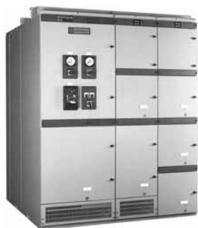
DSII Switchgear Assembly
