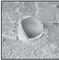
Broken conduit on jobsite
